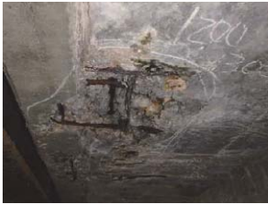
▲橋梁における部材の劣化状況例
