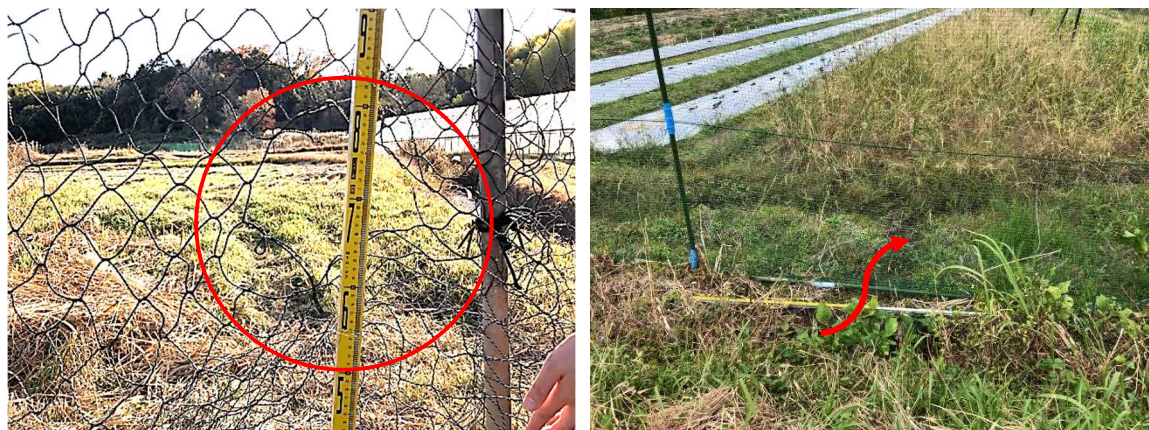
写真 2-2 左：エリア2におけるネットの破損
