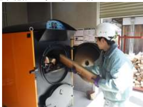
温泉施設に導入された薪ボイラー(天川村)
