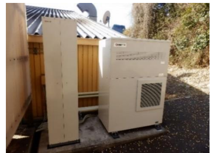
飲食店へのガスコージェネレーションシステムの導入
