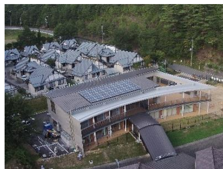
太陽光発電設備及び蓄電池の導入 (野迫川村中学校)
