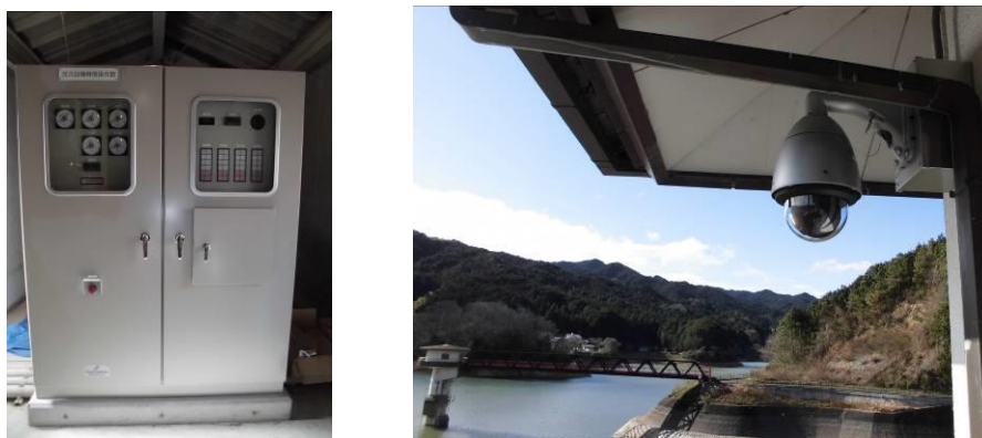
図-3 専用操作卓及び監視カメラ
