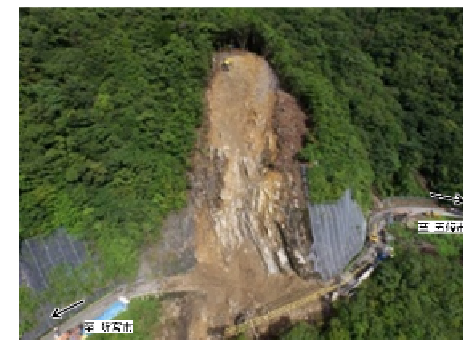
③十津川道路(Ⅱ期)区間 (H27年7月 大規模法面崩落状況)
