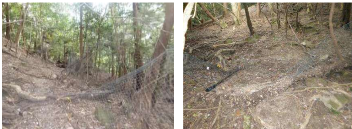
図29 「春日山15-1」 植生保護柵の支柱破損と土砂流入の様子
