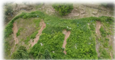
※南側崩落地全景（令和5年崩落（平成29年崩落含む））
