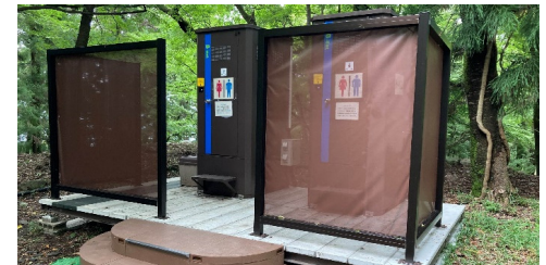
【高取町設置】城跡に設置されたバイオトイレ
