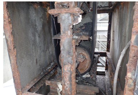
●劣化（錆）が進む焼却炉施設
