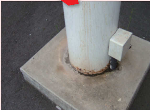
ポールの根元にサビが発生
