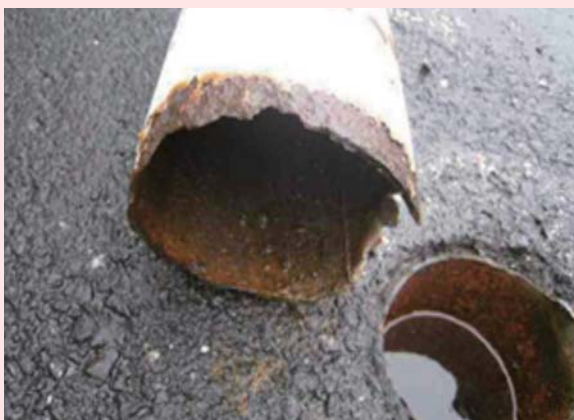
ポールの根腐れによる倒壊
