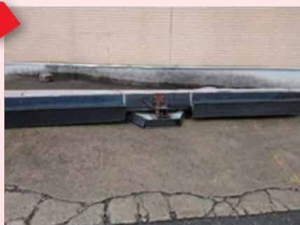
落下した欄間看板
