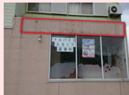
落下した後の壁面
