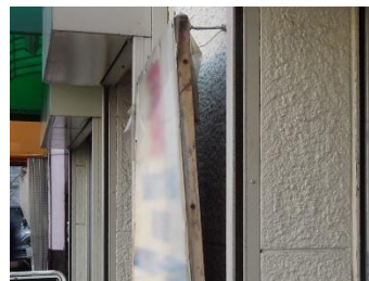
壁面との間に隙間が生じた状態
