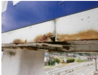
その他（塗装剥離、腐食など）
