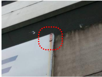
金具が劣化した状態
