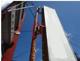
支柱・広告板接合部の腐食・隙間
