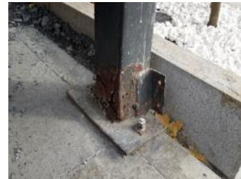
支柱根元の腐食が進行した状態
