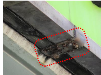
金具が劣化した状態
