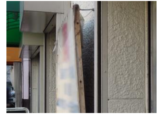
壁面との間に隙間が生じた状態
