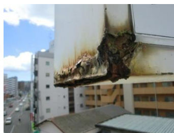
側板の腐食が進行した状態
