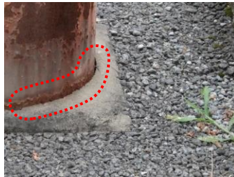
根巻きと支柱との隙間があり、さびが進行した状態
