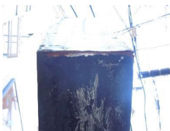
側板底面にさびが発生した状態
