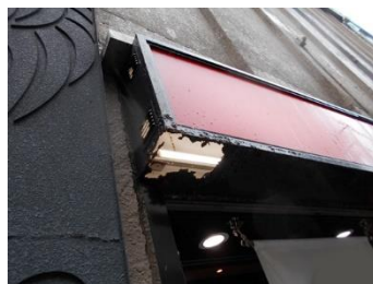
側板底面の腐食が進行した状態
