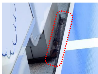
コーキングが劣化した状態
