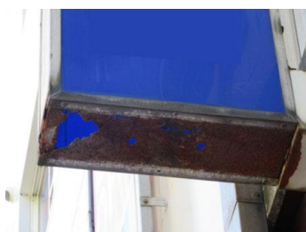
側板底面が腐食、破損した状態
