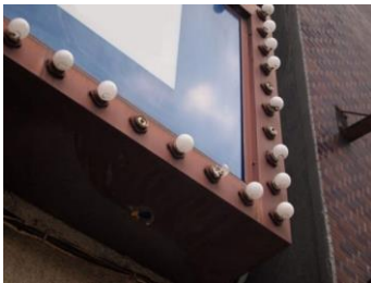
ランプ球が破損した状態
