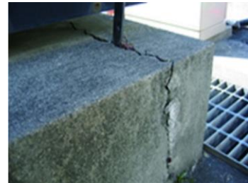
基礎にクラックが入った状態
