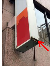
広告板底部の腐食が進行した状態
