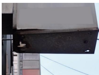
側板底面が腐食、破損、変形した状態
