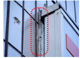
コーキングが劣化した状態
