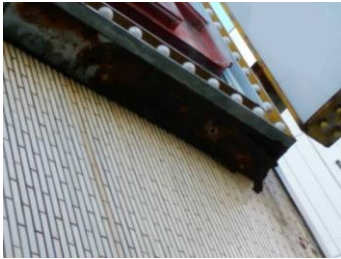
取付部の腐食が進行、汚ダレが見られる状態
