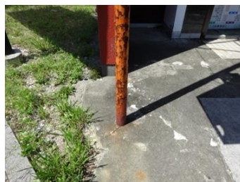
支柱の腐食が進行した状態
