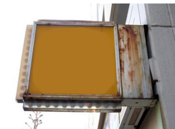
ブラケットカバーにさびが進行した状態
