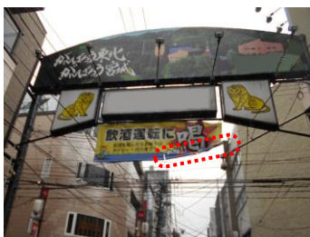
幕材を張る部材が破損した状態
