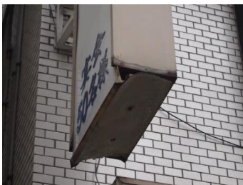
その他 (塗装剥離、腐食など)
