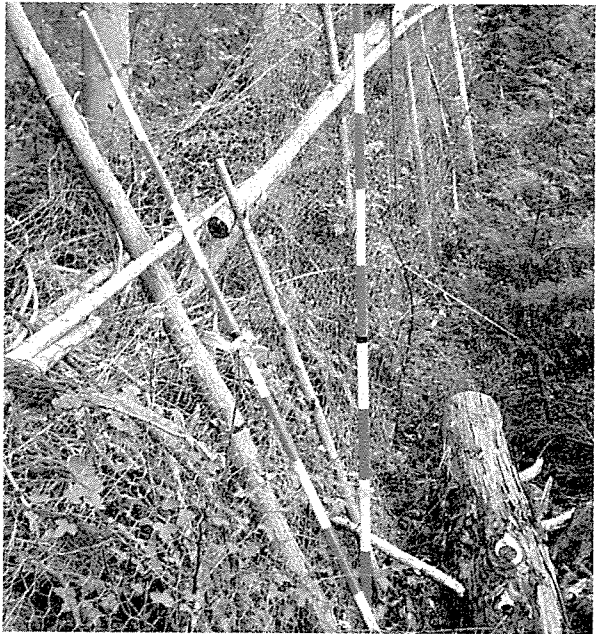
図13 木製の支柱が腐朽して傾いた防護柵 (放置したままではシカが新入するので修理が必要。)
