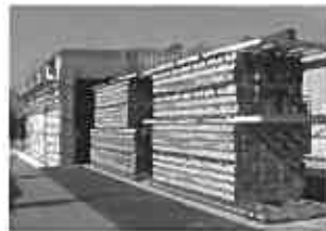
木材乾燥設備
