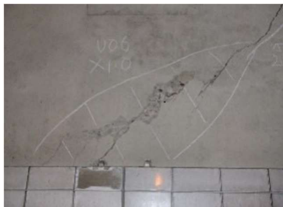
<高原トンネル内クラック状況>
