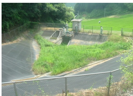
貯水池の老朽化(大和高原南部)
