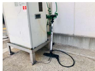
図 25 事業所に空気入れを設置した例
