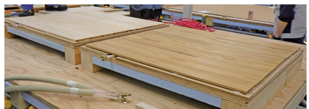
図1 簡易床暖房試験における試験体敷設の様子 (左:無処理試験体、右:処理試験体)
