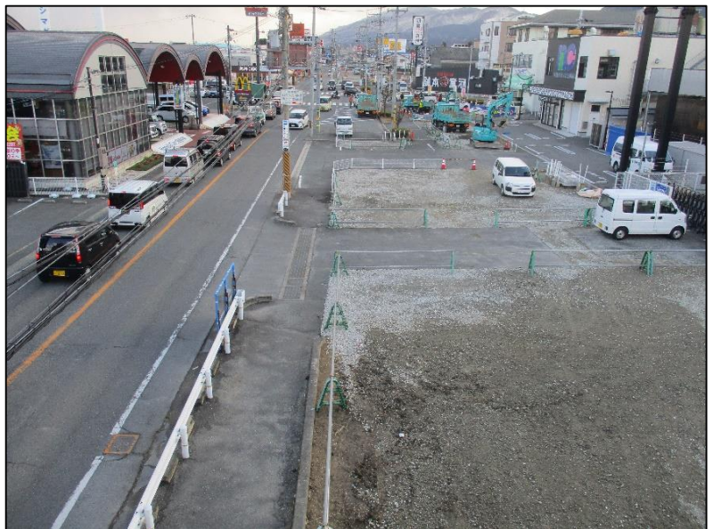
道路の拡幅工事をしています (旭が丘団地東入口交差点付近)
