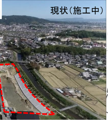
葛下流域貯留施設 (王寺町葛下3丁目地区)
