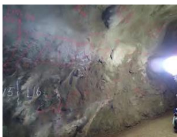
写真 1 うき、ひび割れ
