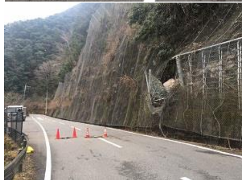
写真-2 国道168号落石発生時
