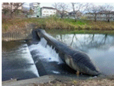
老朽化した農業井堰用
