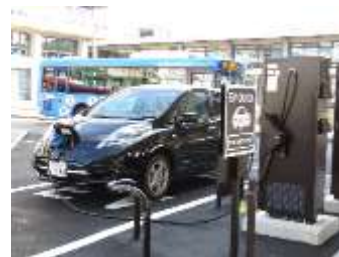
急速充電設備(県本庁舎)
