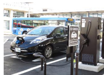
急速充電設備（県本庁舎）
