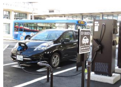
急速充電設備(県本庁舎)
