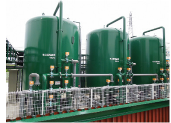
排水を浄化する活性炭ろ過施設
