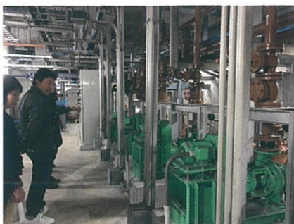
洞川浄水センター内部の設備
