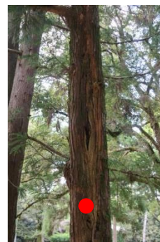
C 腐朽開口
