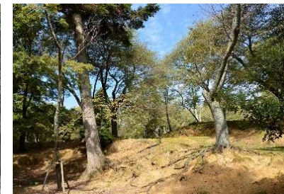
⑤表土が流亡している斜面
