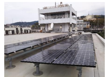
太陽光発電設備及び蓄電池設備の導入 (三郷町役場)
