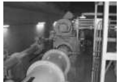
小水力発電システム
