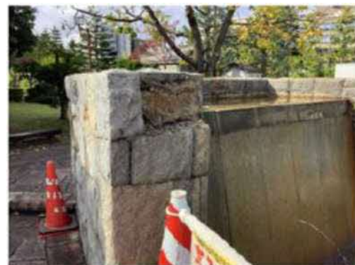
事故発生状況
