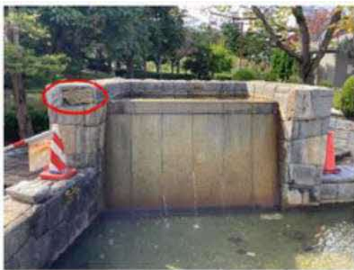
事故発生状況
