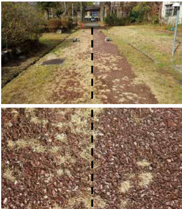
図 11 施工 12 年経過の舗装 6) (上) とそれらの拡大 (下) (左：無処理木チップ使用、右：過熱蒸気処理木チップ使用 撮影日：2021/1/26)
