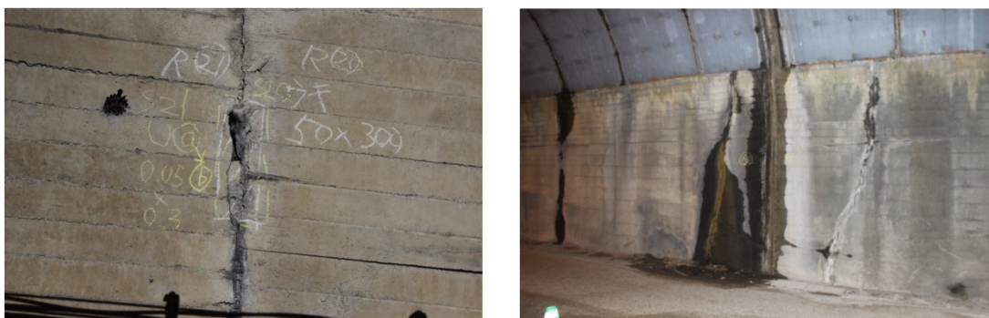
写真2 変状例（左：うき 右：漏水）
