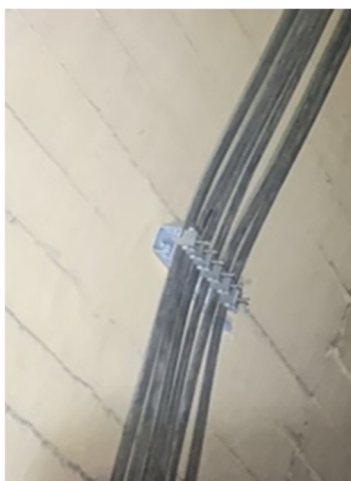
ケーブルラダーで固定
