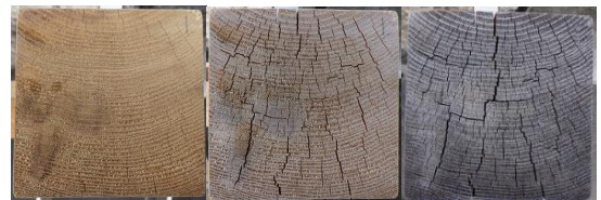
図3 角柱上端木口面の割れの進行 左：施工後1ヶ月、中：施工後2ヶ月、右：施工後17ヶ月
