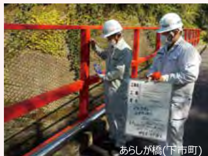
▲県が受託し、市町村職員が県職員と一緒に修繕工事をした橋梁 あらしが橋(下市町)
