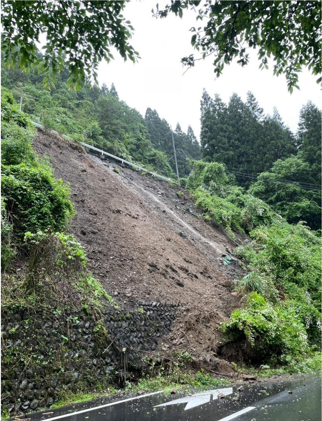
①R168 崩土現場写真
