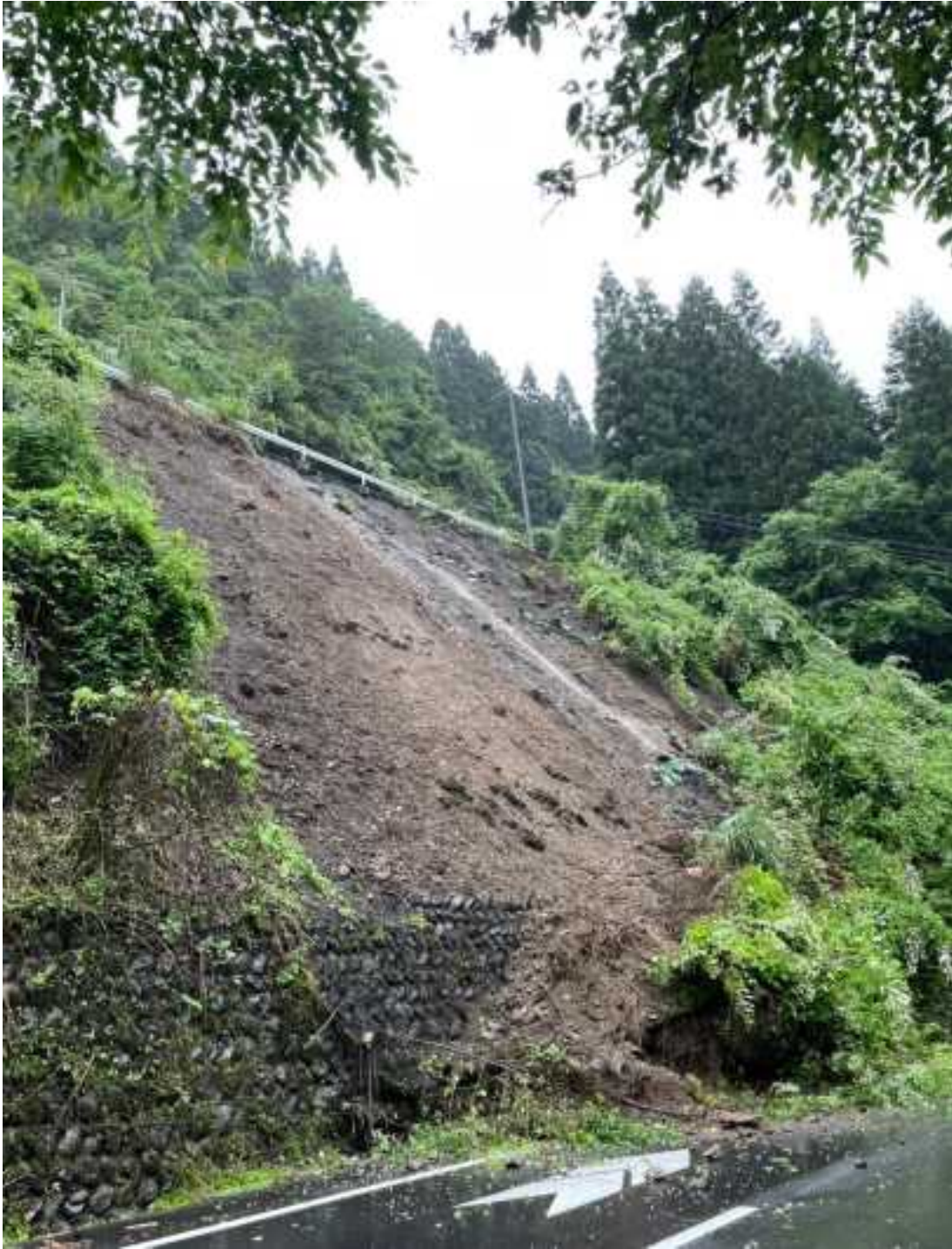
①R168 崩土現場写真
