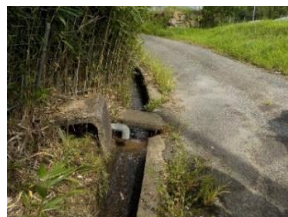
老朽化した水利施設
