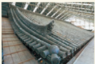
瓦を一枚一枚調査し、できる限り元の瓦を再利用しています。
