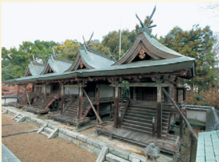
修理前の状況（建物の傾斜を止めるため、斜めの部材が追加されています。）
