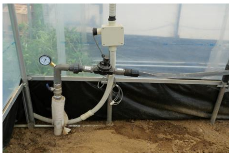
制御盤に繋がる電磁弁及び水量計のついた灌水設備
