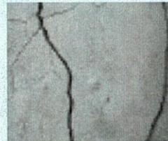
コンクリート壁のクラック
