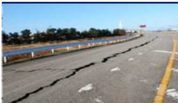
道路舗装が被災
