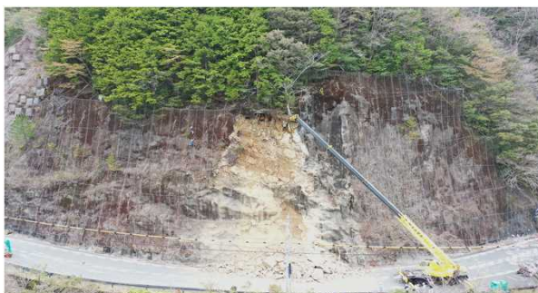
土砂崩れ(法面崩壊)が発生
