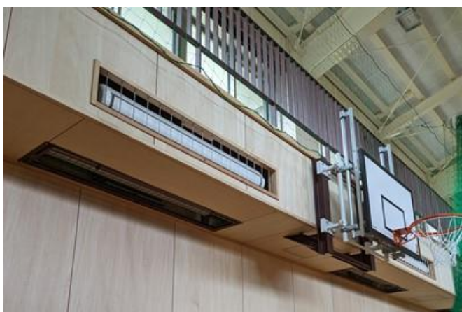
空調設備 (指導訓練棟)
