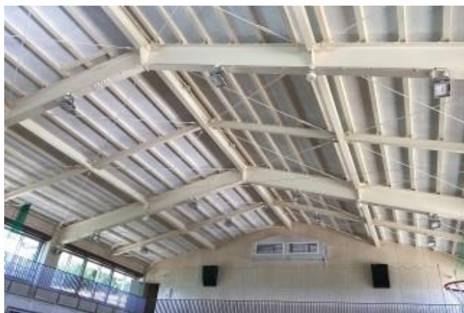
照明設備 (指導訓練棟)
