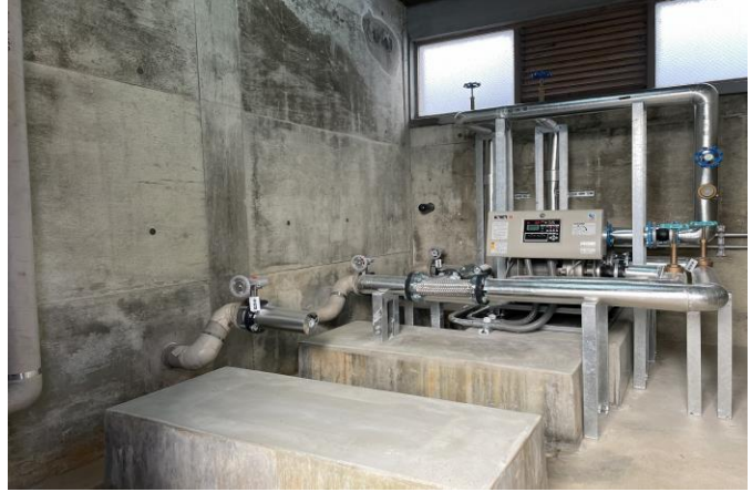
6, 7号棟ポンプ室
