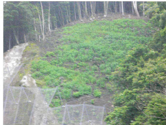
P-16 樹木の根元付近に浮き石見られる
