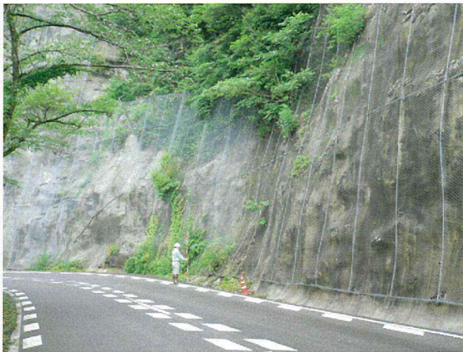
P-10 法面上部が沢地形となっている
