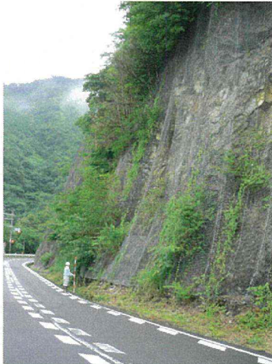
P-9 法面露岩が比較的大きな岩塊となっている
