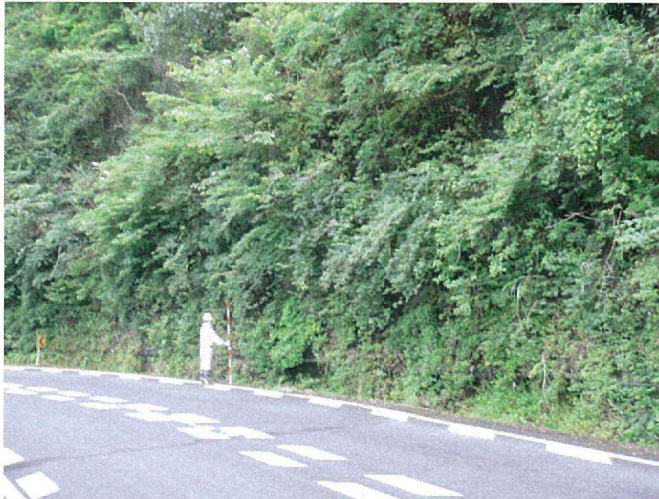
P-5 法面露岩部にはロックネット設置されている。露岩は亀裂発達し、草本茂る
