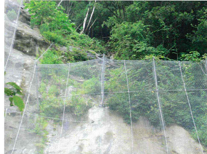
P-11 上部斜面は急峻である
