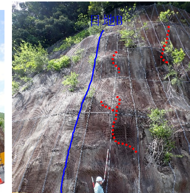
⑨モルタルのクラック状況
