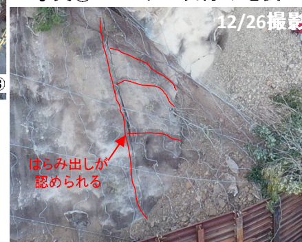
写真③ モルタル吹付の亀裂、目地の開口
