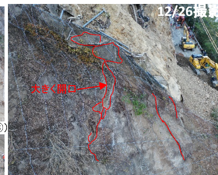
写真② モルタル吹付の亀裂
