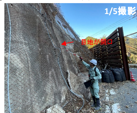
写真④ モルタル吹付の目地の開き
