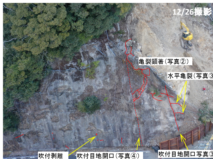
写真① 終点側(南側)モルタル吹付の変状分布状況
